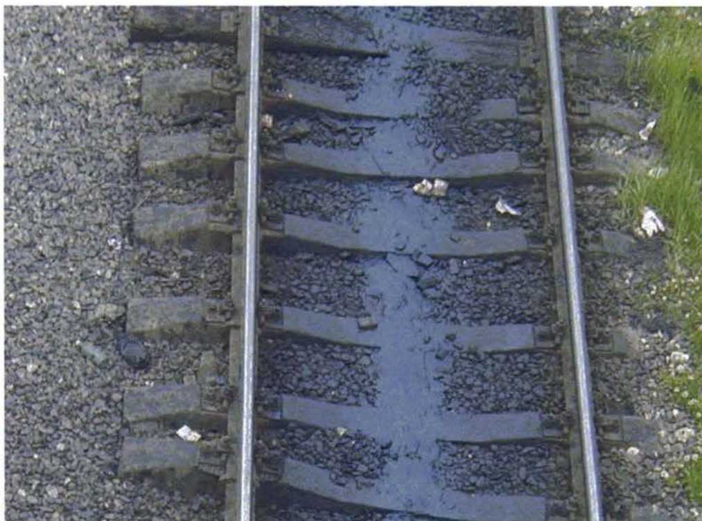
Рисунок 16: Загрязнение земли на рельсовых путях
