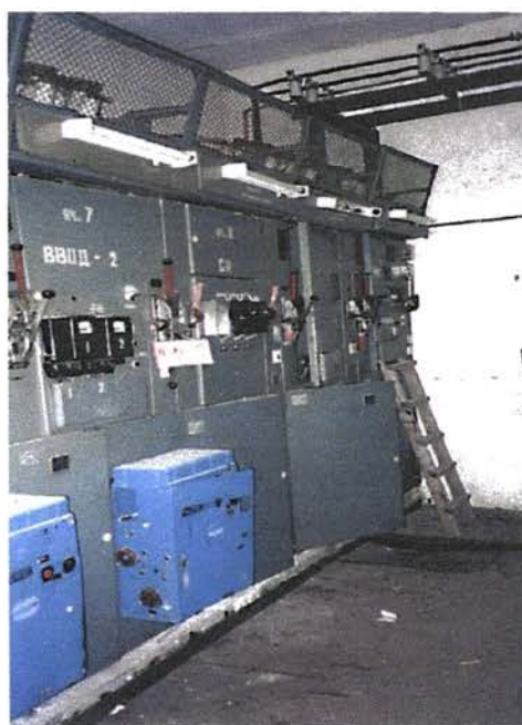
22. Электрические щиты внутри трансформаторной подстанции ТР 803.
