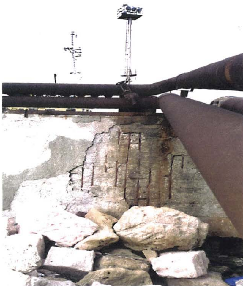
8. Восточная сторона центрального пирса (старые нефтяные трубы и повреждённый бетон).
