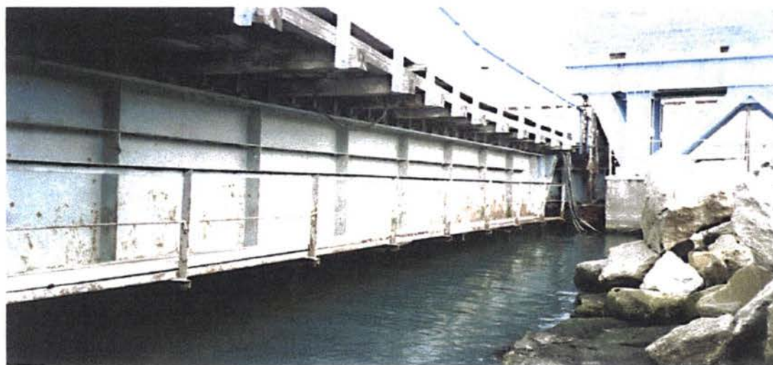
17. Коррозийная направляющая платформа.
