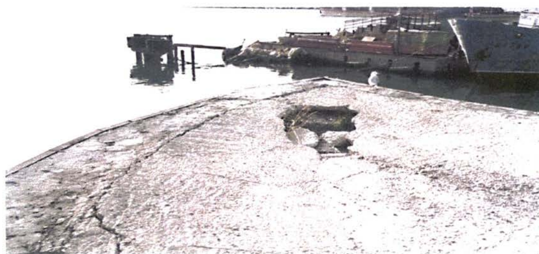
13. Треснувшая бетонная мостовая на поверхности пальцевидного пирса.
