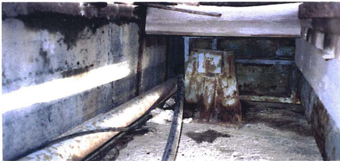
16. Коррозийные поворотные подшибники на поверхности земли (на правом борту).
