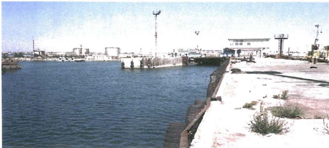
10. Повреждённая мостовая центрального пирса.
