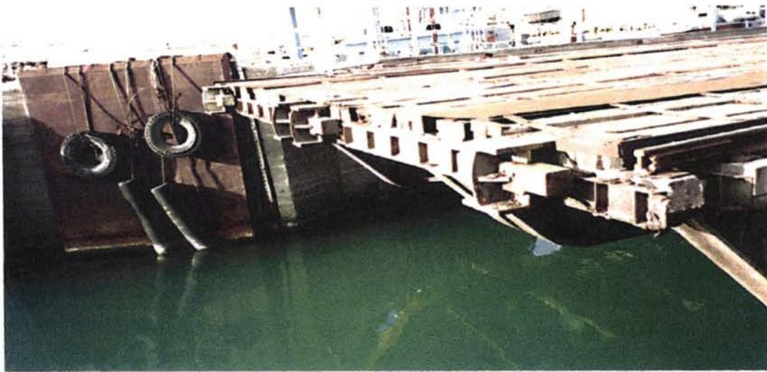
15. Плохая защита на правом борту стоп-рамы.
