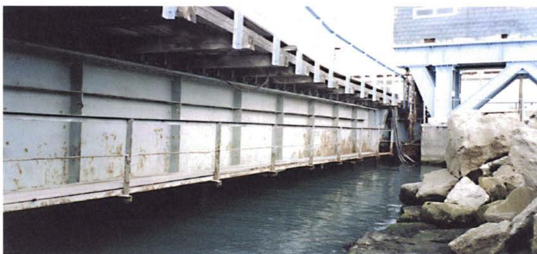
17. Коррозийная направляющая платформа.
