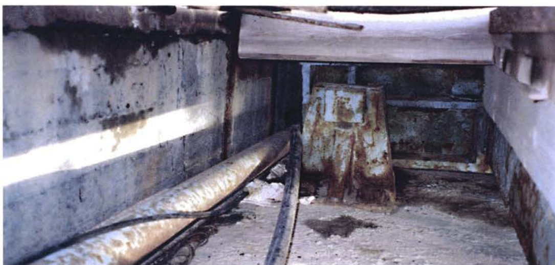
16. Коррозийные поворотные подшипники на поверхности земли (на правом борту).
