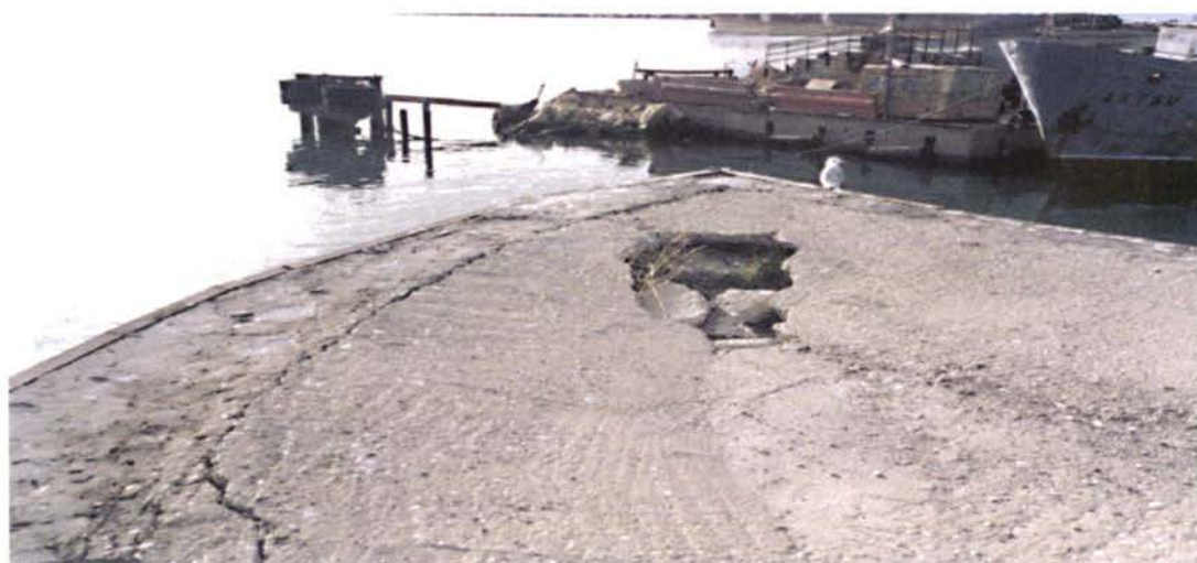
13. Треснувшая бетонная мостовая на поверхности пальцевидного пирса.
