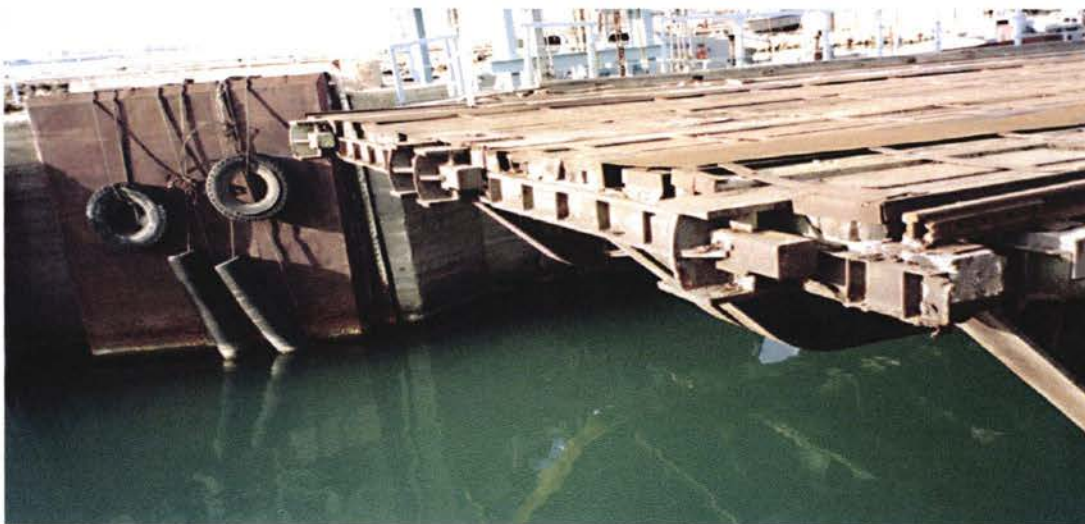
15. Плохая защита на правом борту стоп-рамы.
