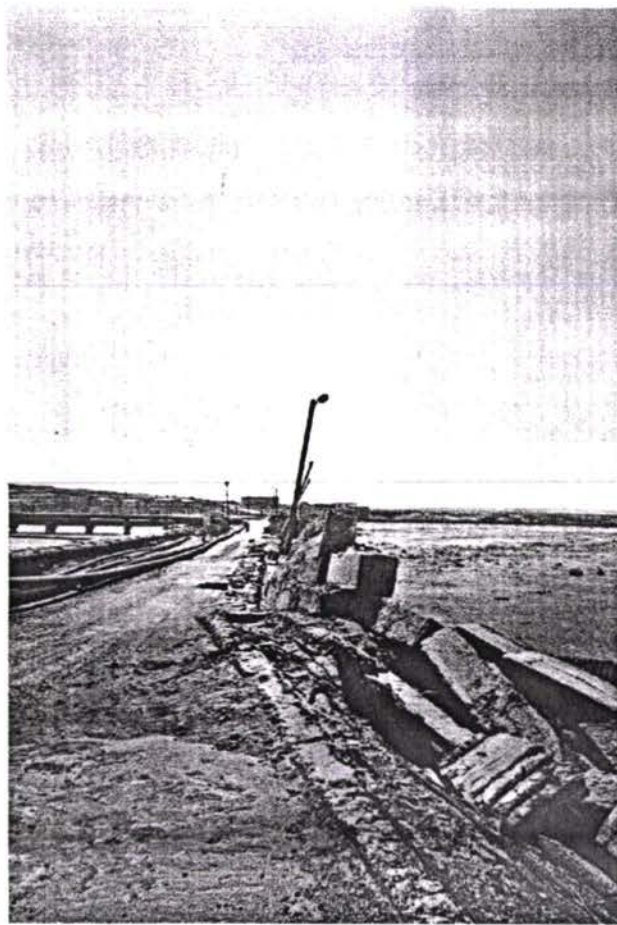
4.2. Дубенди. Разрушенная парапетная стена волнолома
