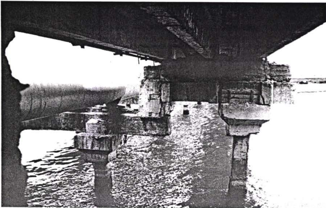
10.2. Дубенди. Ветхость бетонного столба
