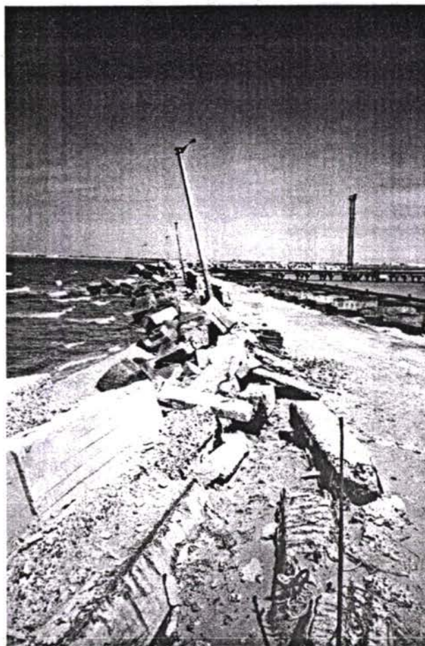
4.2. Дубенди. Разрушенная парапетная стена волнолома
