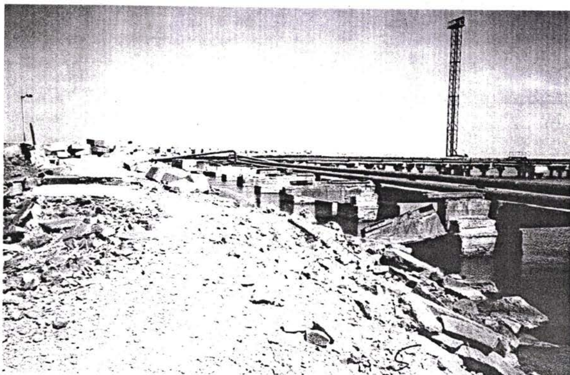
4.4. Дубенди. Ветхий трубопровод вдоль волнолома
