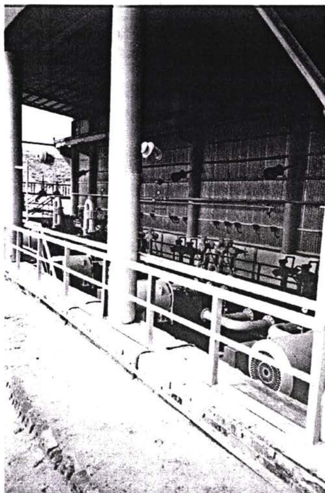
20.4. Дубендинское нефтяное хранилище. Насосная станция Каспиан Транско
