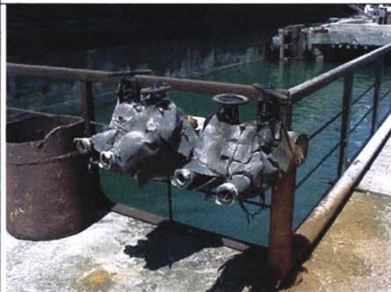
Система борьбы с огнём на пирсе 1, без водного снабжения, изолирующий слой частично нарушен или испорчен, трубопроводная арматура поворачивается с большим усилием, шланг и насадка не имеются
