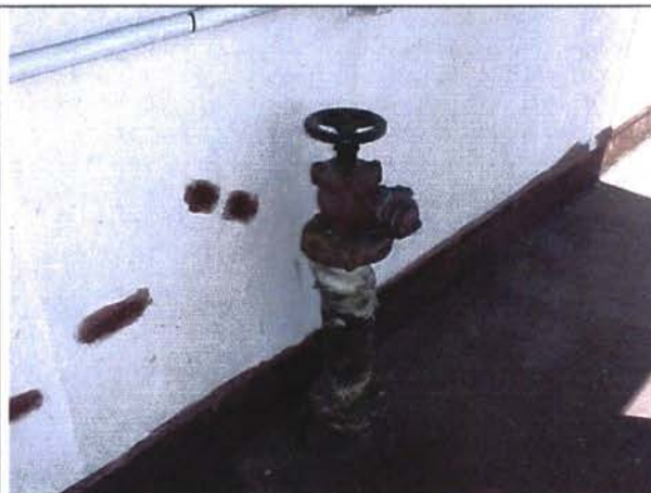
Гидрант, вентиль не поворачивается
