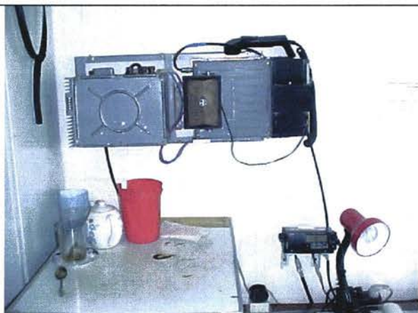
Контрольный центр порта с радио оборудованием.
