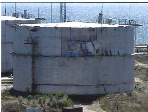
Вид с Административного Здания на нефтяные цистерны находящиеся в плохом состоянии.
