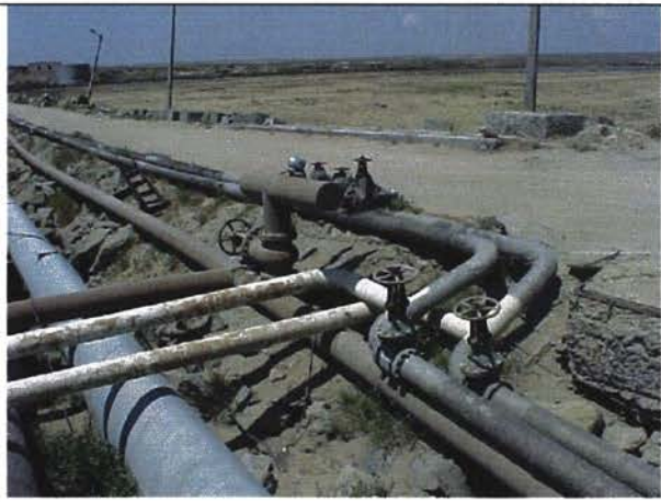
Трубопровод от берега до пирса 1, 2 и 5 для борьбы с огнём.
