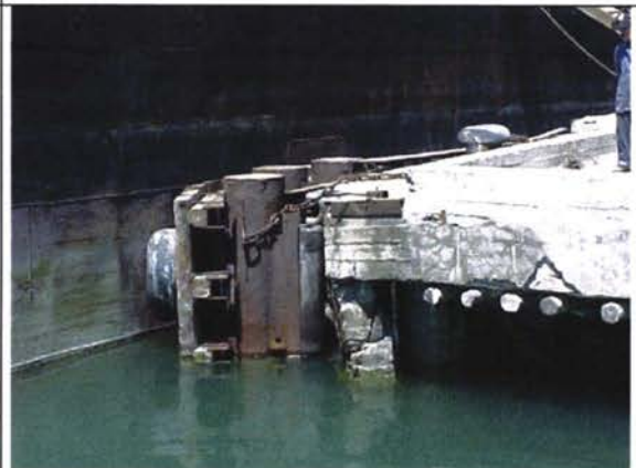
Сломанная бетонная труба пирса 1 и бамперная система
