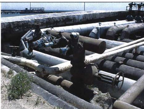
Трубопровод и система борьбы с пожаром на пирсе 1, без водного снабжения, изолирующий слой частично нарушен или испорчен, трубопроводная арматура поворачивается
