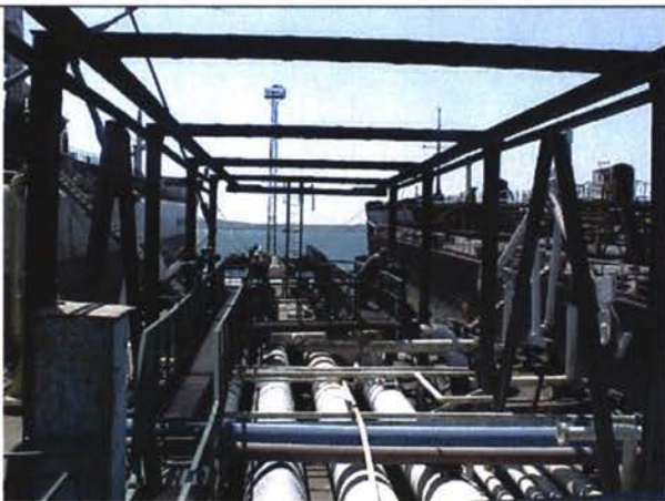
Вид на систему трубопроводов пирса 1
