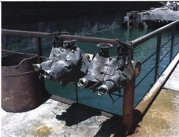
Система борьбы с пожаром на пирсе 1, без водного снабжения, изолирующий слой частично нарушен или испорчен, трубопроводная арматура поворачивается с большим усилием, шланг и насадка не имеются
