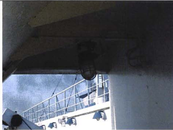
Испорченная лампа на потолку около станции спасательных лодок.
