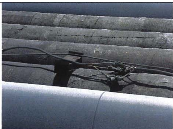
Трубопровод с пирса 1, 2 и 5 до берега с электрическим кабелем
