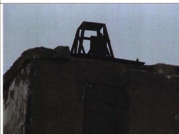
Вид на верхнюю часть радиомаяка Шихов, поврежденное кирпичное (из песчаного известняка) сооружение и патрон лампы, лампа отсутствует
