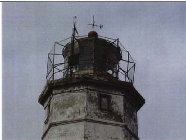
Маяк Нardжин: Вид на верхнюю часть маяка с разбитым оконным стеклом и поврежденной облицовкой
