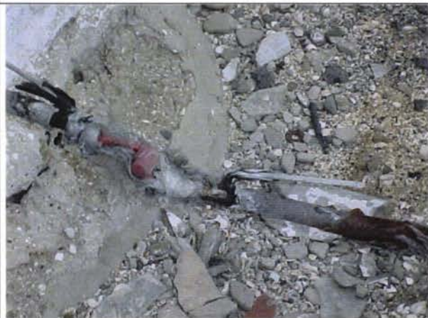
Нетрадиционное наружное кабельное соединение (220 Вольт) между генераторным сооружением и маяком
