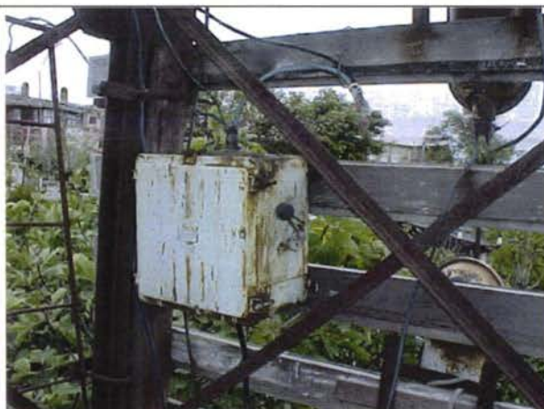
Башня 1: Распределительный ящик
