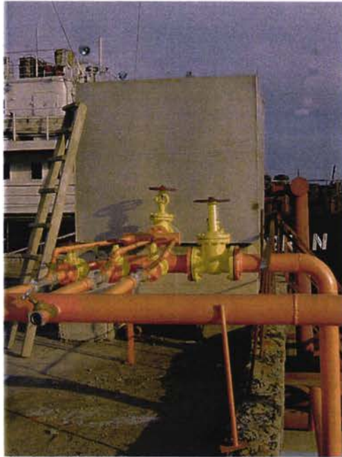
19. Pier n°3. New foam tank
