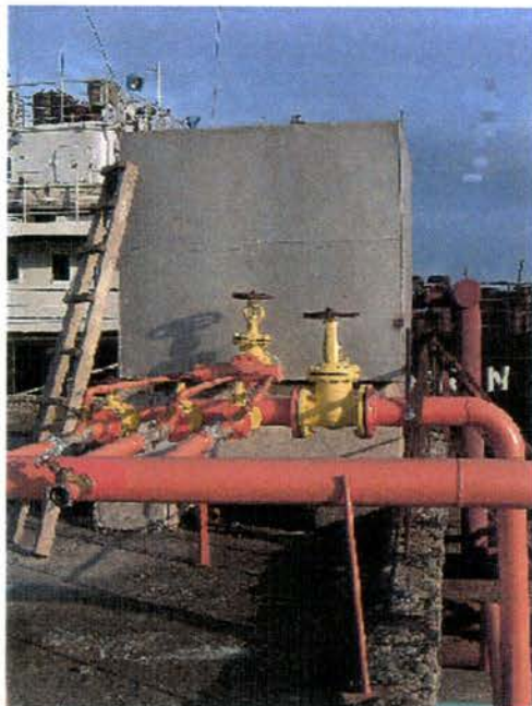
19. Pier n°3. New foam tank
