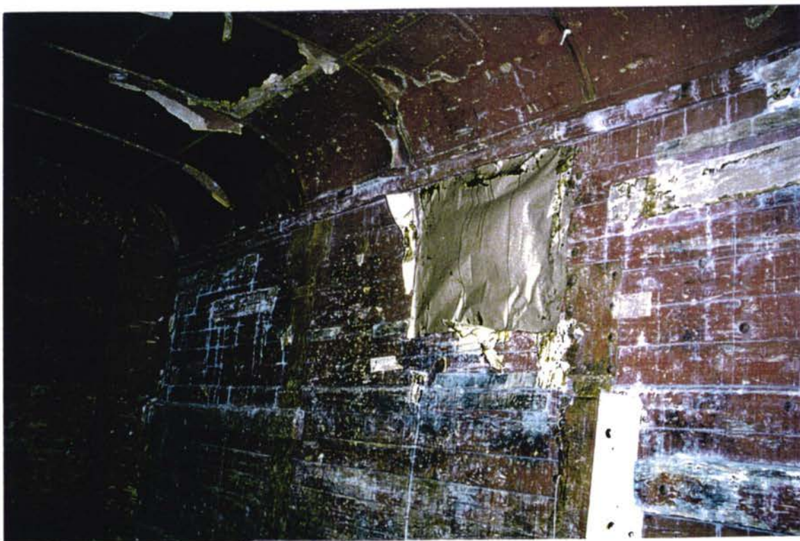
Вентиляционные люки в стене загерметизированы
